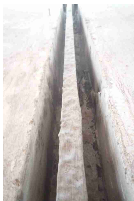
4- montant traité contre la corrosion
